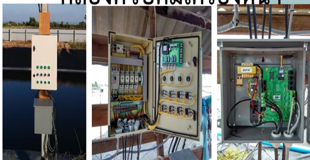
กล่องควบคุมเครื่องตีน้ำ
