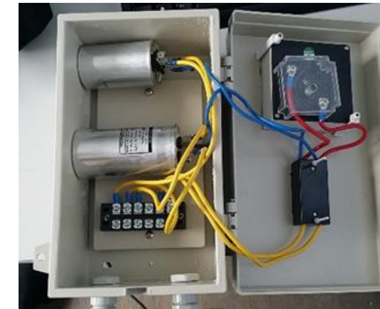
1 kW ชุดควบคุม
