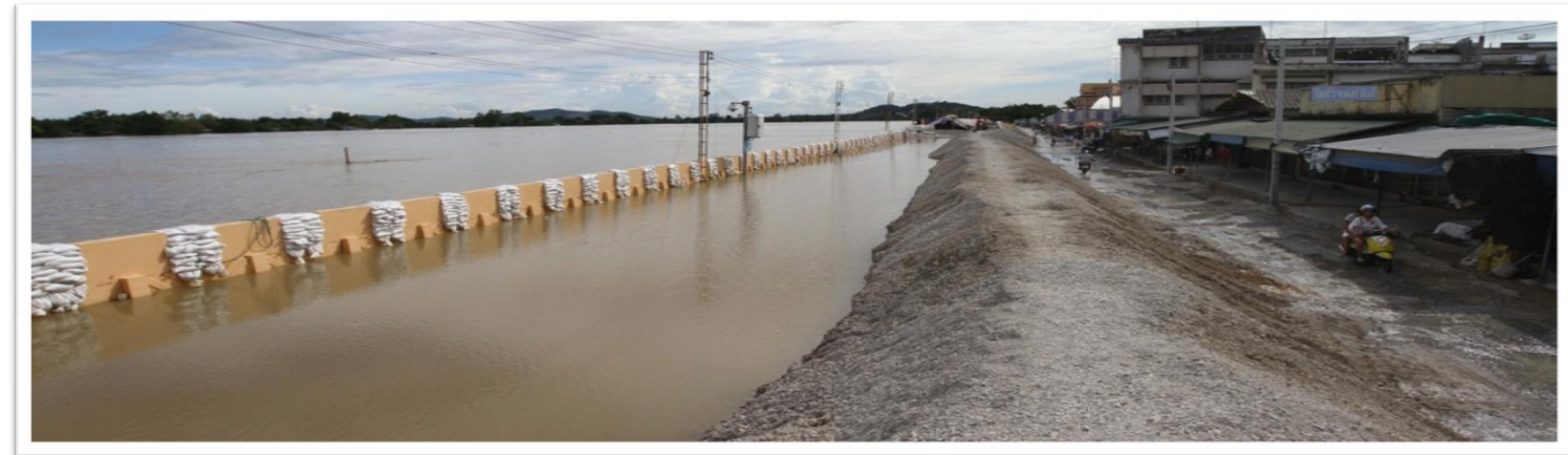
คันกั้นน้ำทำด้วยหินคลุก ที่เทศบาลเมืองนครสวรรค์
